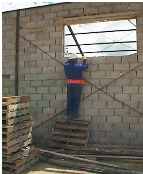
Queda prohibido el uso de escaleras de mano de construcción improvisada.
