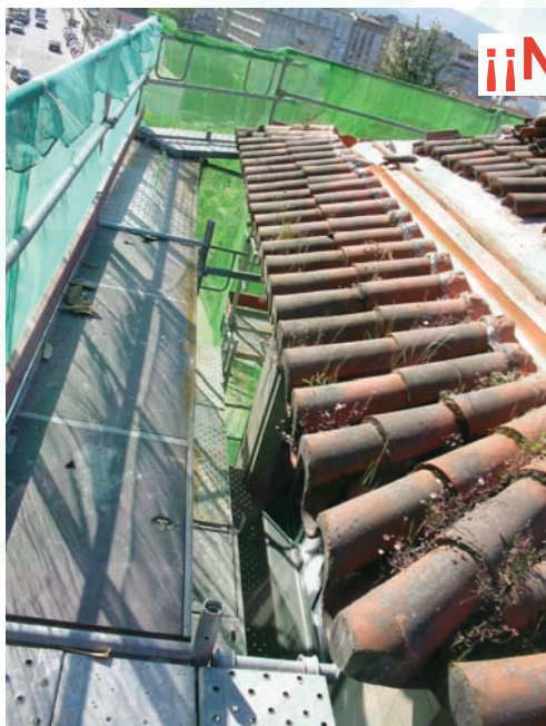
HUECOS SIN PROTEGER. VACIO PELIGROSO
